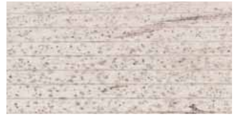
Stockflecken/Schimmel auf der Oberfläche
